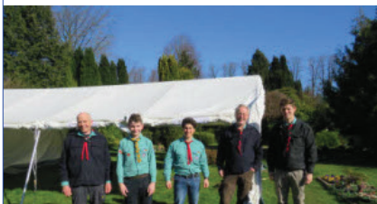
Die Pfadfinder Andreas Sprung (v.l.), Bo Jürgensen, Sina Shakrizi stellten mit den Pastoren Frank Boysen und Björn Ströh einen Unterstand am Gettorfer Friedhof auf, damit Trauernde nicht im Regen stehen müssen.
