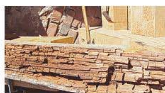
... und Hausschwamm machten die Sanierung von St. Jürgen notwendig. DREESEN
